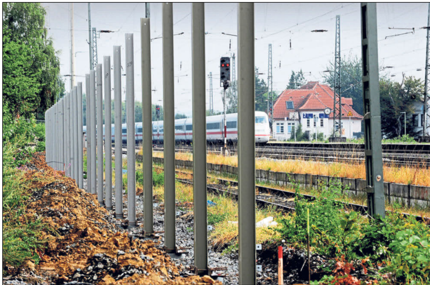
Die ersten Pfähle der neuen Lärmschutzwand stehen schon in Höhe des Braker Bahnhofs.
